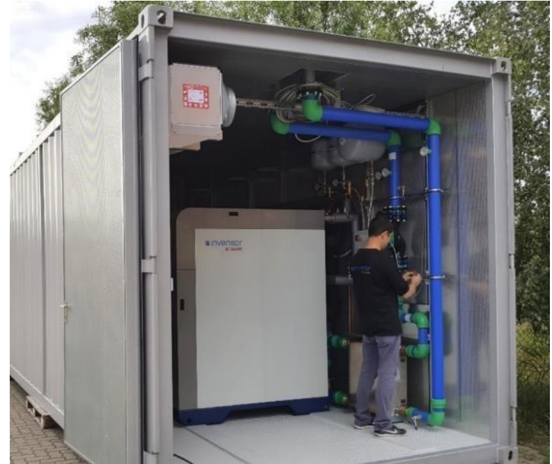
Blick in einen InvenSor Container
