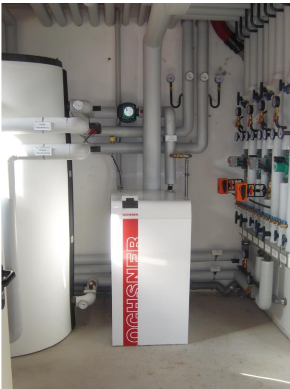
BU: Wärmepumpen können nicht nur Wärmen und Kühlen, sondern zeichnen sich auch durch sehr geringe Wartungskosten und eine hohe Verfügbarkeit aus (Foto: LEKA MV/Arne Rakel)
