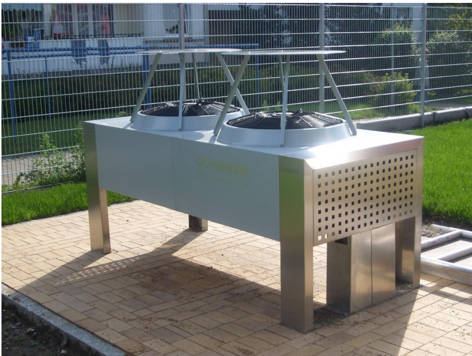
BU: Wärmepumpenanlagen können in Gewerbe und Industrie Wärme und Dampf erzeugen auf Temperaturniveaus von bis zu 130 Grad (Foto: LEKA MV/A. Rakel)
