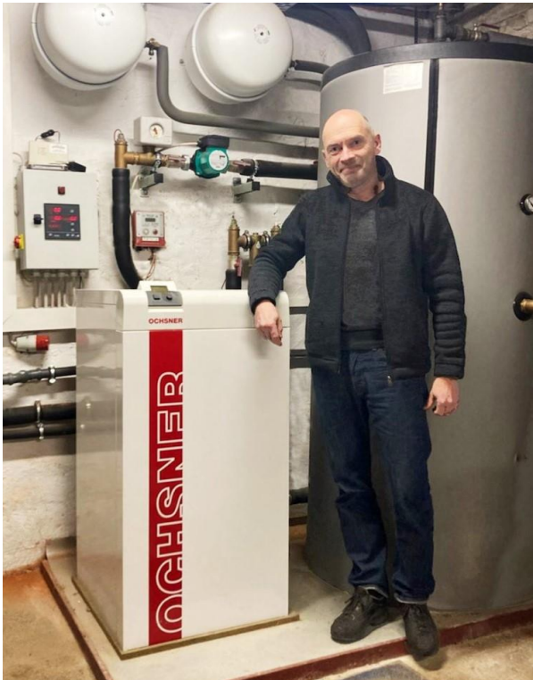
BU: Arne Rakel, Technischer Berater der LEKA MV, hat lange Jahre Wärmepumpen entwickelt, geplant und eingebaut (Foto: LEKA MV/A. Rakel)
