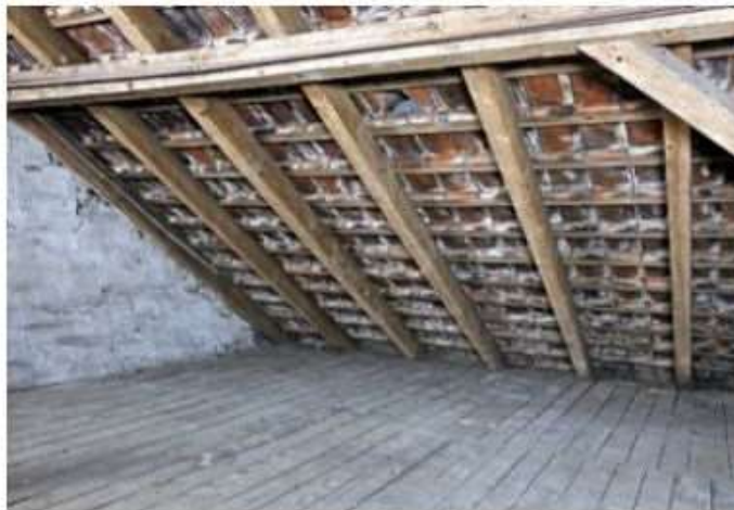
Viele Altbau-Dachböden entsprechen längst nicht mehr den heutigen Anforderungen an energiesparendes Wohnen. (Quelle: djd/Paul Bauder)
