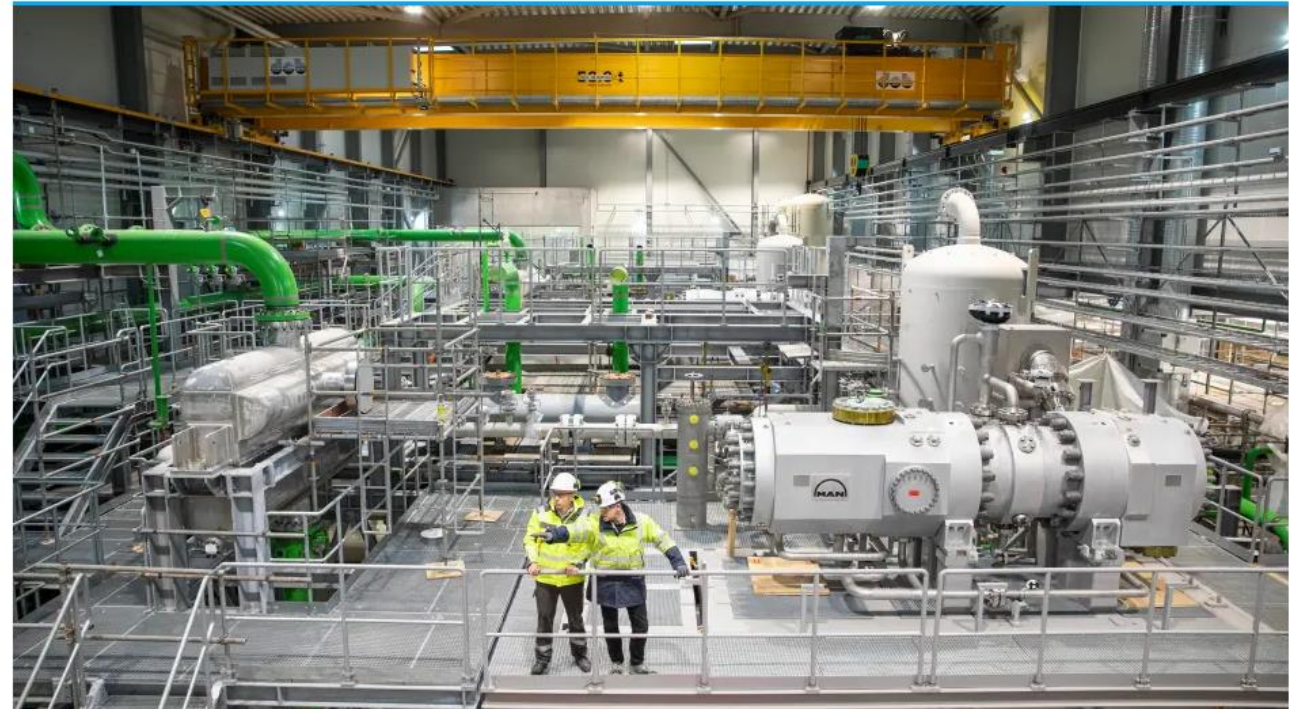
Die Großwärmepumpe von MAN Energy Solutions in Esbjerg in Dänemark versorgt 100.000 Menschen mit Wärme.
