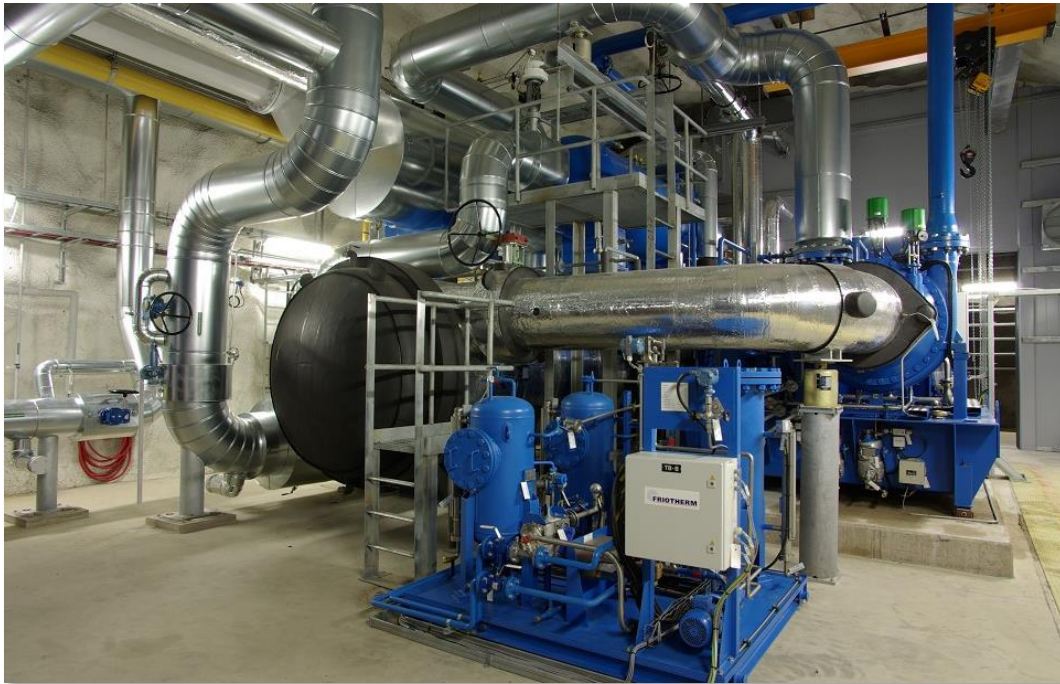
Quelle: FrioTherm, Unitop® 50 Wärmepumpe, Helsinki Energia, Helsinki, FI,
